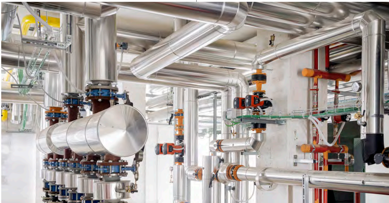
Impianti tecnologici realizzati da Ing.Ferrari S.p.A. per il nuovo Marco Polo Building della Zambon S.p.A.
